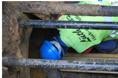
Querende Leitungen in Baugrube
